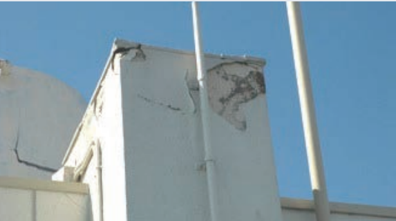
小山 雨ヶ谷寮各部ひび割れ(写真は屋上部分)
