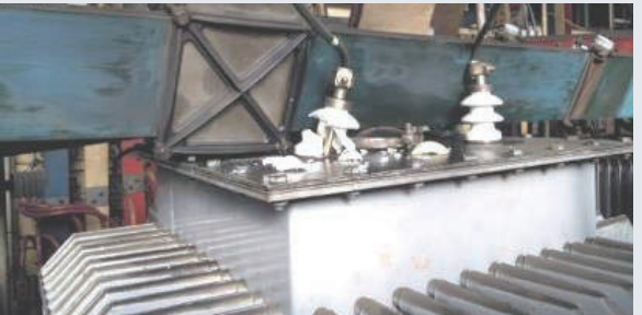
ヨロズ栃木 第一変電所(トランス損傷)
