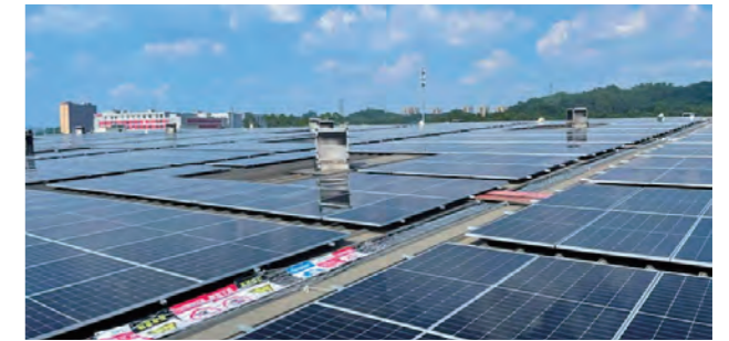
Massive solar panels installed at Guangzhou Yorozu Bao Mit Automotive Co., Ltd. (G-YBM)
